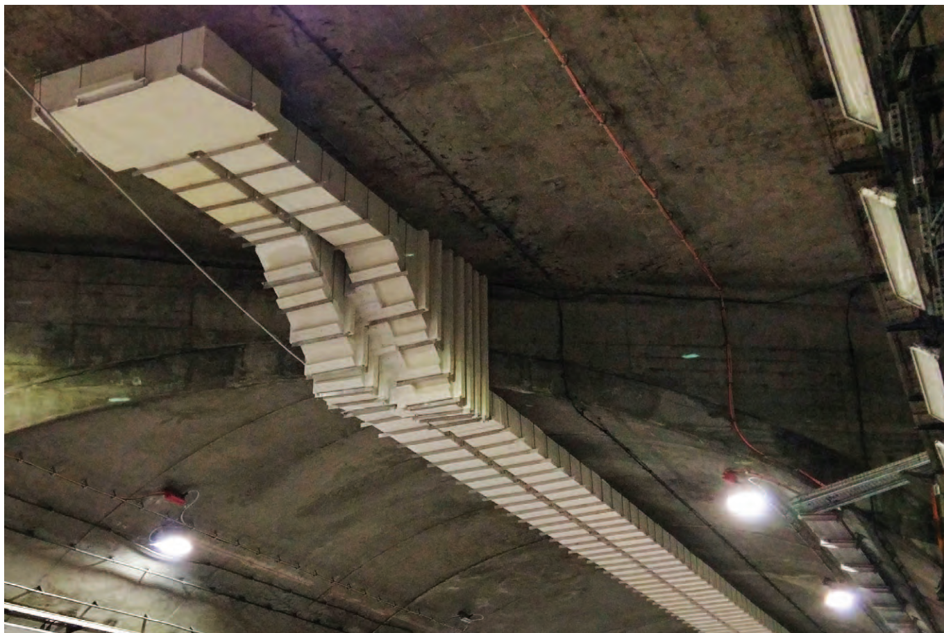
Goulotte de câbles avec maintien du fonctionnement
