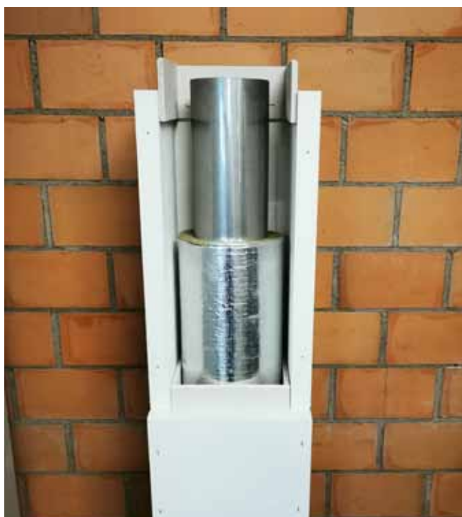
Gaine technique pour conduit de fumée
