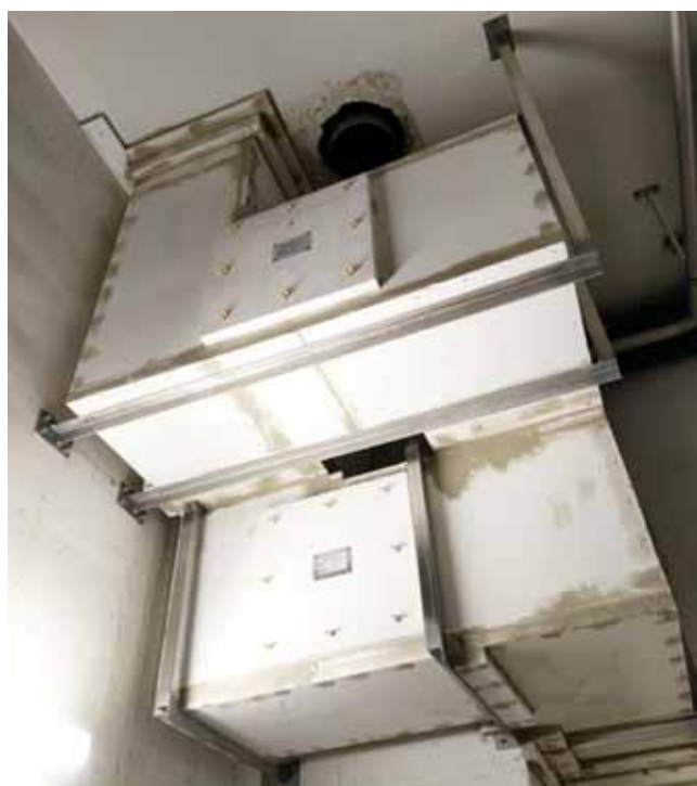
Gaine technique pour conduit de fumée
