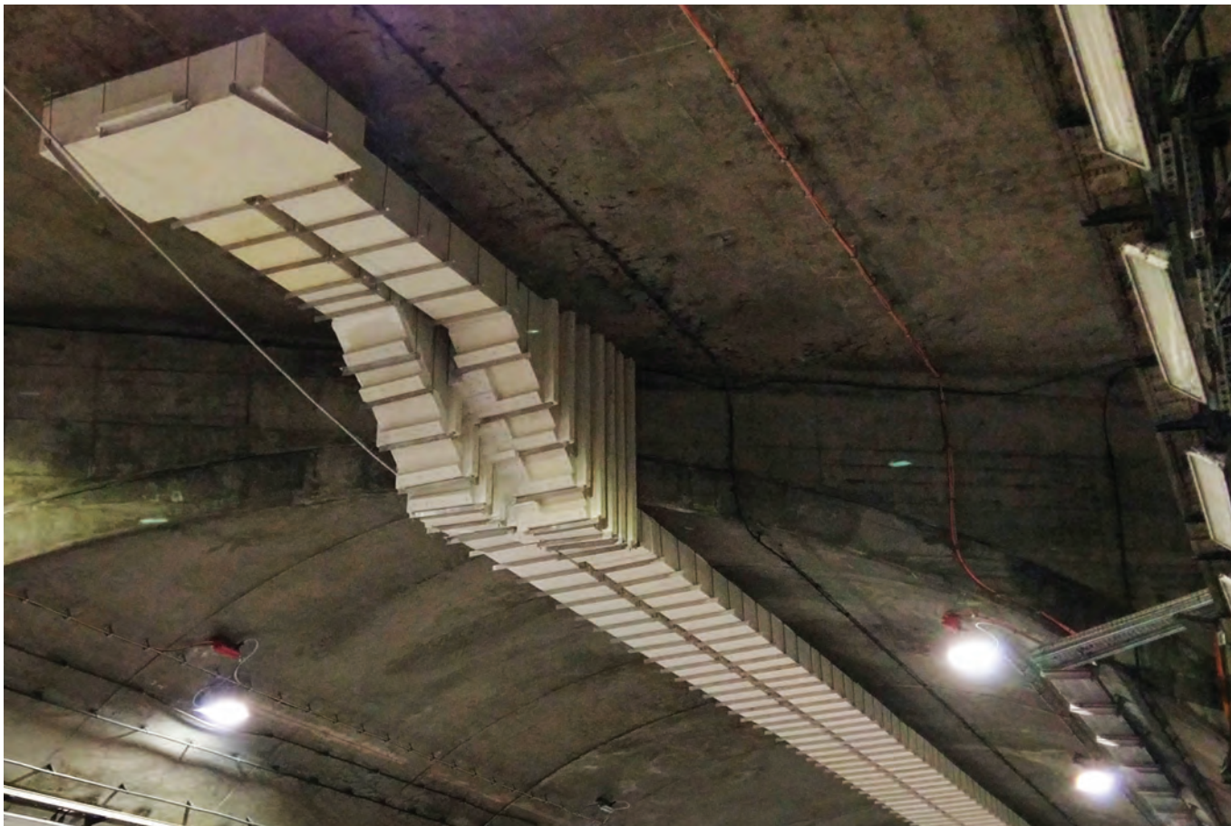
Kabelkanal mit Funktionserhalt
