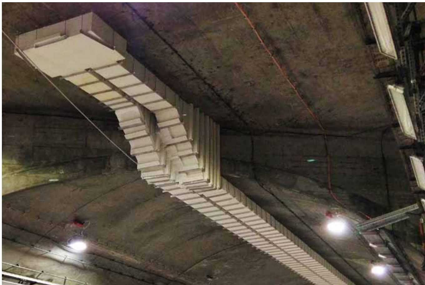
Goulotte de câbles avec maintien du fonctionnement
