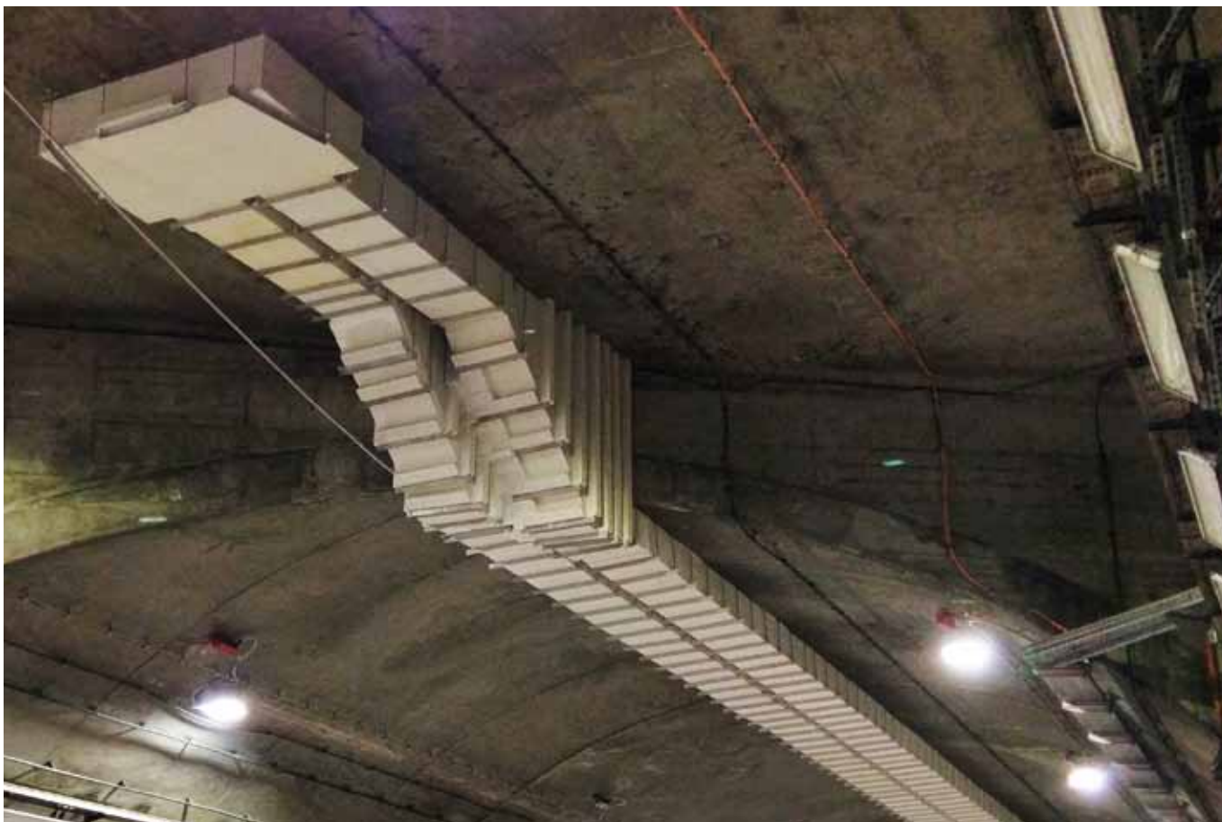
Kabelkanal mit Funktionserhalt
